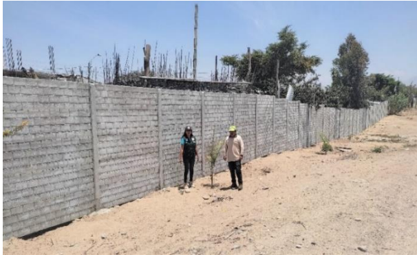
Cerco perimétrico en el Parque Ecológico Gola Meir.
