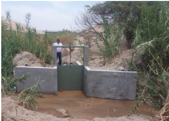
Compuerta que permite el ingreso de agua a Gola Meir.
